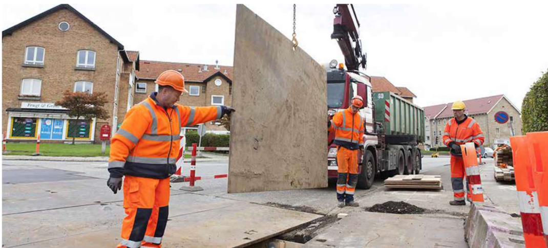
Figur 8. Fjernvarmeudbygning i Lyngby.
