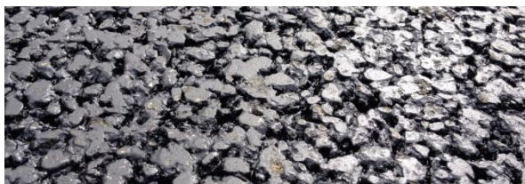
Figur 27. Nærbillede af et nyt og mindre støjende slidlag (teknisk betegnelse: SMA-8). Både den meget jævne og åbne overfladestruktur ses tydeligt. En traditionel belægning (f.eks. SMA-11) har en grovere og mere ujævn struktur.
