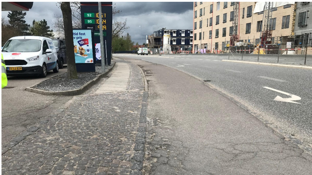
Foto 5: Nedslidt belægning på sydlig fortov og cykelsti
