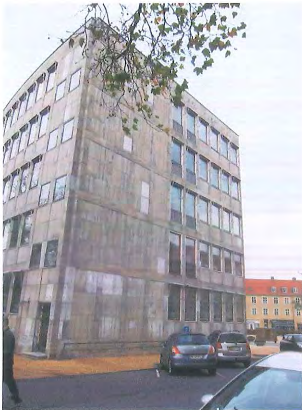
Trods sognerådets ønske lykkedes det at få trukket vinduesnicherne ganske lidt tilbage fra facadeflugten. Den grønlandske marmor har ikke vist sig så langtidsholdbar, og man har måttet reparere med en anden marmortype
