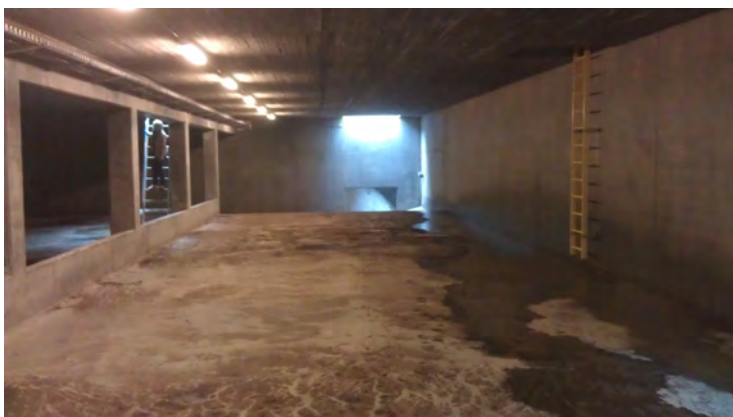
Billede 2. Underjordisk regnvandsbassin
