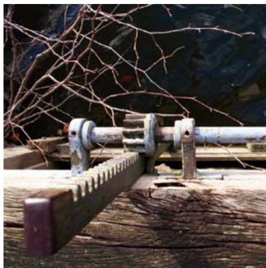
Frislusens stigning med jernhejseværk. Tavlen er nyere, men selve rammen og hejset er af ældre dato. Foto: Morten Stenak
