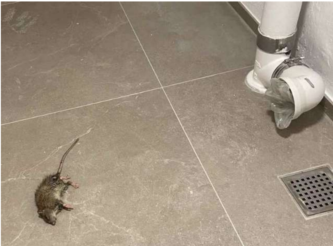
Ubenyttede afløb og stikledninger skal altid afproppes korrekt, uanset om det er en midlertidig afpropning
