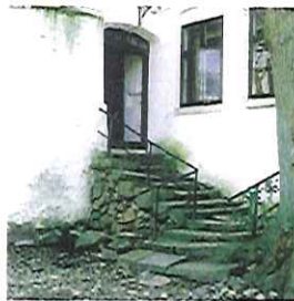
Stentrappe med alvorlige sætningsproblemer. Trappen er hovedsageligt opført ved anvendelse af gamle granitkvadere. Foto: Erik Einar Holm
