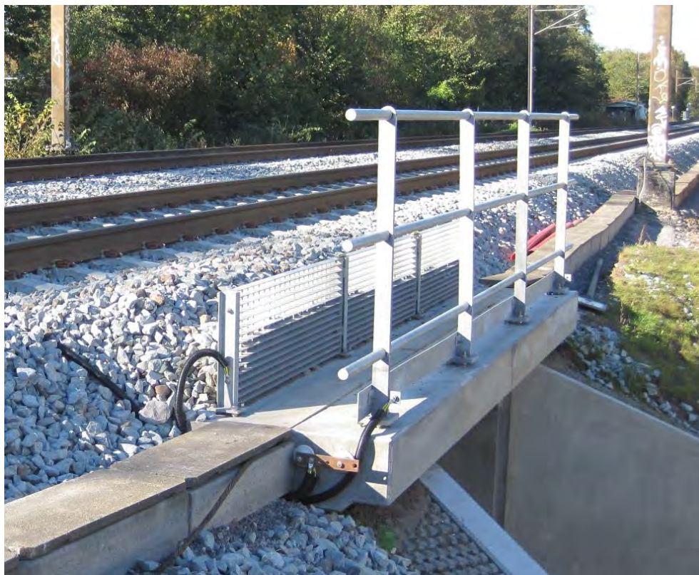
Billede 2 Eksempel på kabelføring gennem brokonstruktion samt ballastkot i stål
