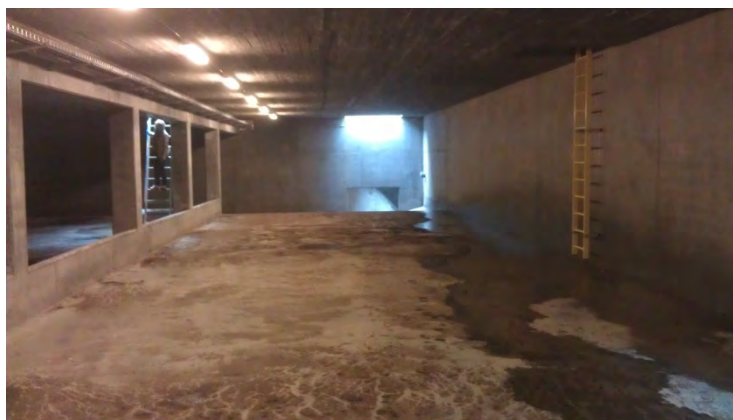
Billede 2. Underjordisk regnvandsbassin
