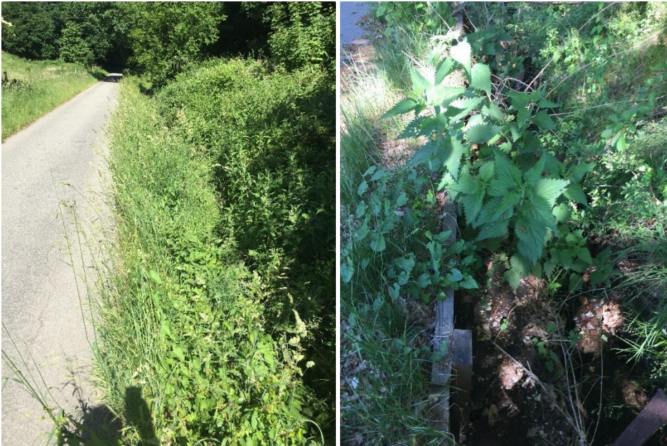
Figur 5 Til venstre ses grøften langs stien lige efter udløbet og til højre den tørlagte grøft med brinksikring mod stien.
