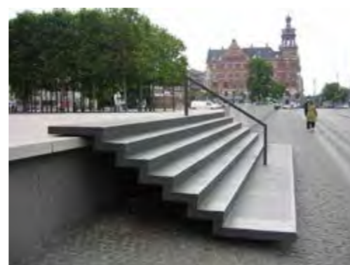
Terrassedækket udføres i træ men ses som en 'foldet' konstruktion. Inspiration Jamers Plads
