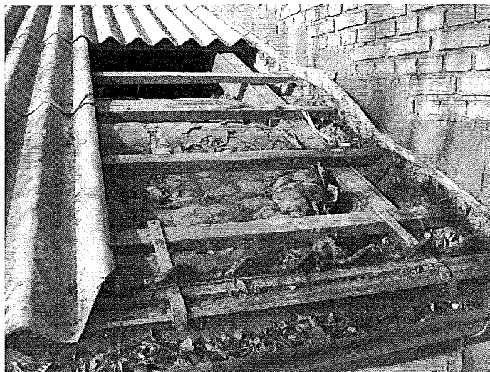
Figur 7 Samling mellem forbygningens tag og skillemur mod hallen. Her ses den mangelfulde inddækning på østsiden og sorte udfældninger lige under inddækningen.
