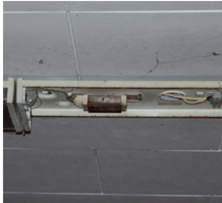
Ældre armaturer til lysstofrør indeholder ofte PCB.
