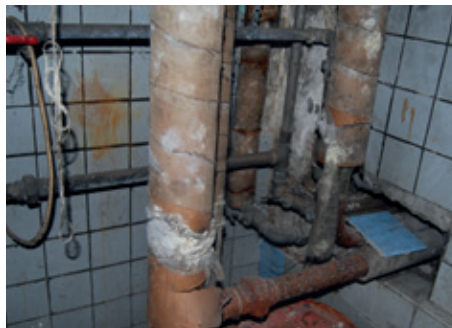
Rørisolering indeholdende asbest. Arbejdstilsynets regler skal følges ved asbestarbejde.
