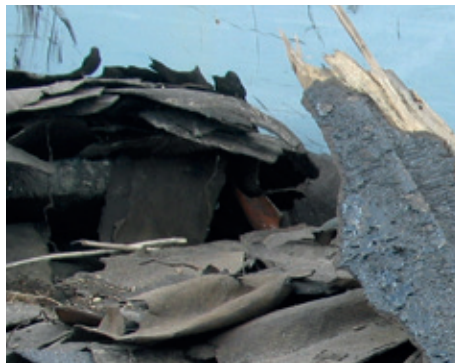
Ældre tagpap fra nedrivning. Ældre tagpap kan indeholde tjærestoffer. Tagpap deponeres eller genanvendes.
