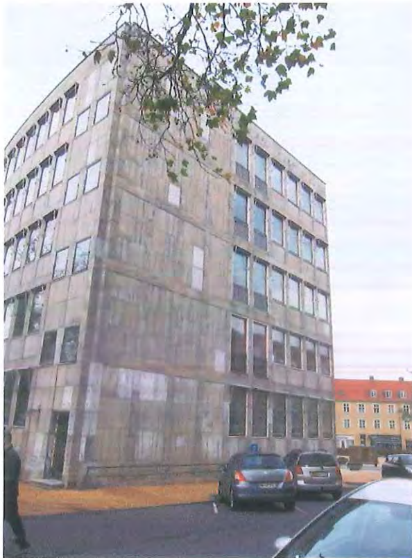
Trods sognerådets ønske lykkedes det at få trukket vinduesnicherne ganske lidt tilbage fra facadeflugten. Den grønlandske marmor har ikke vist sig så langtidsholdbar, og man har måttet reparere med en anden marmortype
